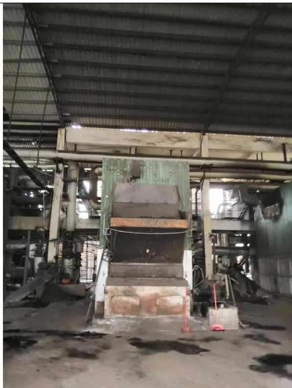
锅炉房现状：在用锅炉
